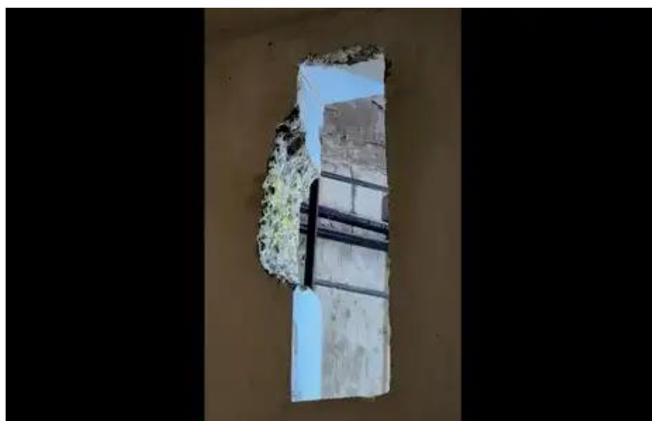
Buraco na parede da cela de onde saíram os fugitivos – PF/Divulgação
