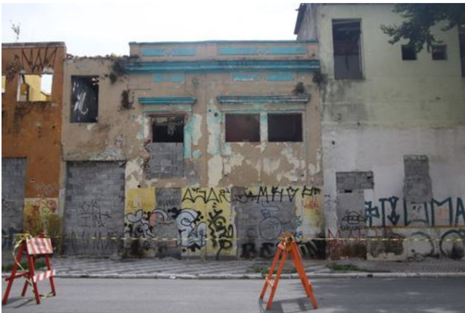
Prédios interditados na Rua Helvétia - Rovena Rosa/Agência Brasil
